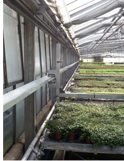
Abb. 61: An der Stellwand wurde nachträglich eine Führungsschiene zur Stabilisierung des Druckluftgestänges installiert.
