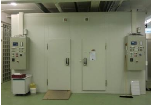
Abb. 2: Klimakammern an der LfL in Freising mit automatischer Temperatur und Licht-Regelung
