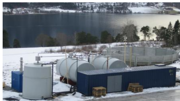
Gårdsbasert biogassanlegg for husdyrgjødsel på Tingvoll ved oppstart. Tankene er senere isolert og anlegget er bygd inn. Foto: NORSØK
