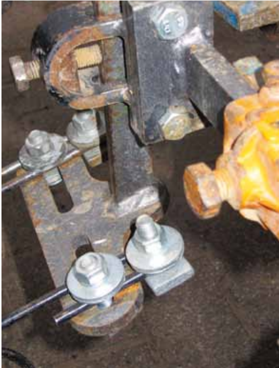
Abb. 3.7.3: Die Grundplatte der Halterung wurde abgetrennt und im Winkel von ca. 105^\circ schräg wieder angeschweißt (ursprünglich 90^\circ ).
