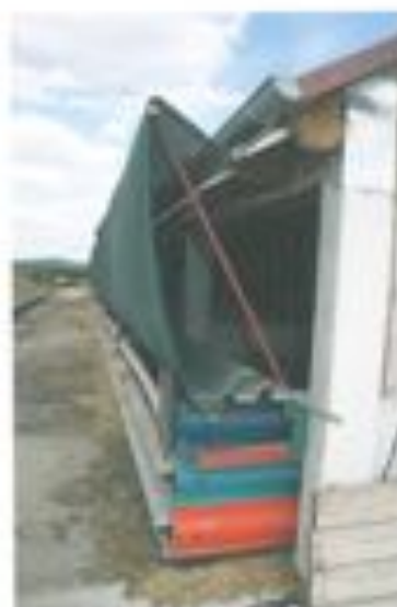
Betrieb 3: Die Auslaufbegrenzungen sind für die Schlepper-Extrmistung eingezogen.
