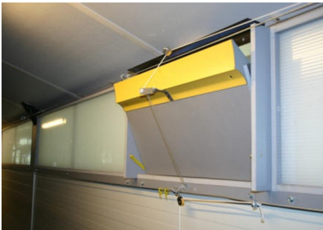
Figuur 9.7 Lichtstraat met een lichtdicht luchtinlaatventiel (bron: www.tulderhof.com )
