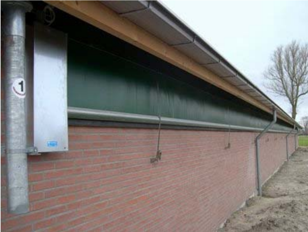
Figuur 9.11 Ventilatiegordijn. Een gordijn om de ventilatie te regelen kan ook worden gebruikt om de hoeveelheid daglicht te regelen (bron: www.boonagro.nl )
