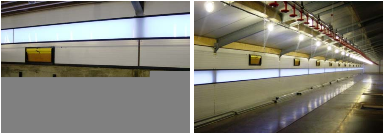
Figuur 9.2 Lichtstraat in de wand van de stal (bron: www.tulderhof.com ).
