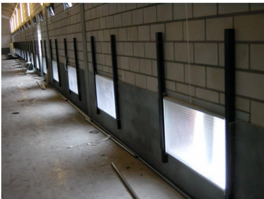
Figuur 9.6 Lichtdoorlatende uitloopschuiven (bron: www.tulderhof.com )
