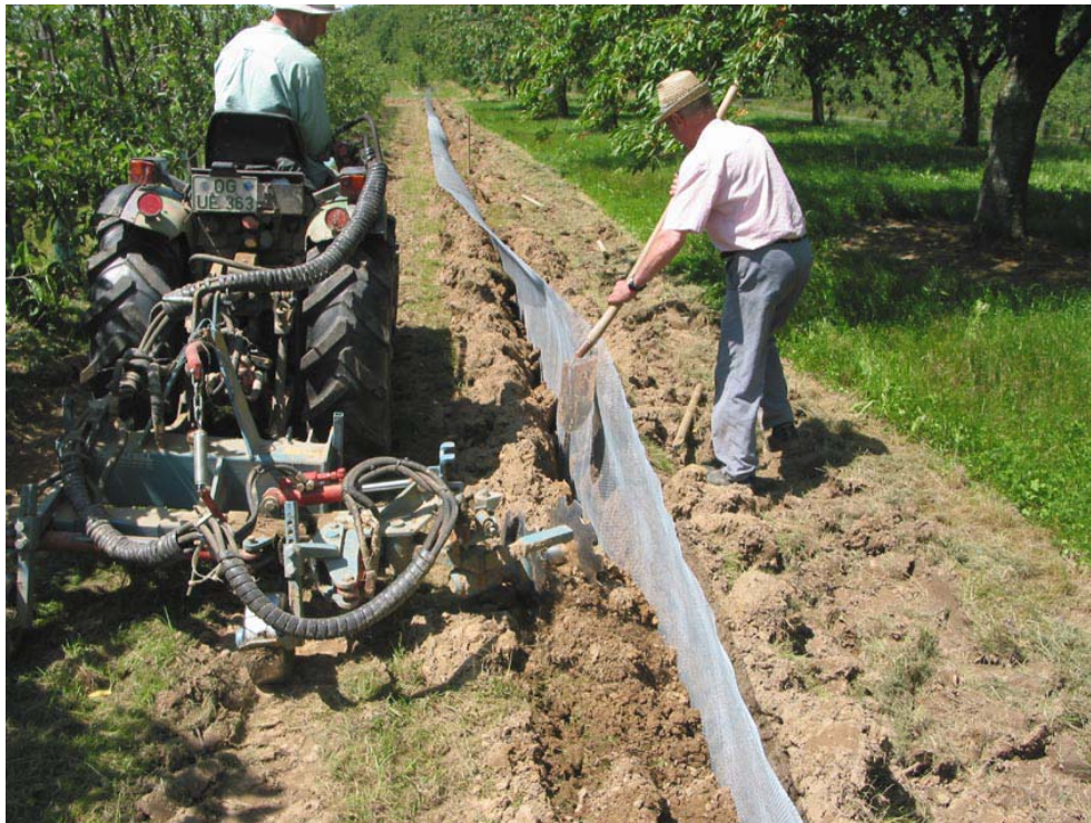
Abb. 6: Der Erdauswurf wird mit einem Speedo-Unterbaumpfleegerät an die Barriere geworfen und der Graben verfüllt.
